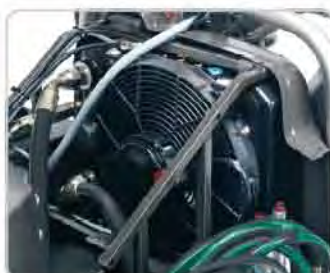
Automatický elektrický ventilátor pro zvlášť účinné chlazení.
