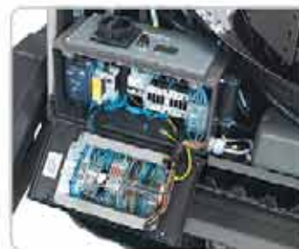
Stroj se vzhledem ke snadnému přístupu ke komponentám dobře udržuje.
